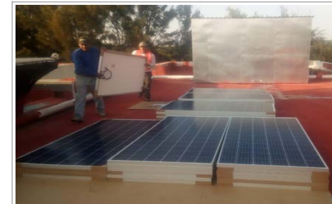
F5: Suministro en azotea
