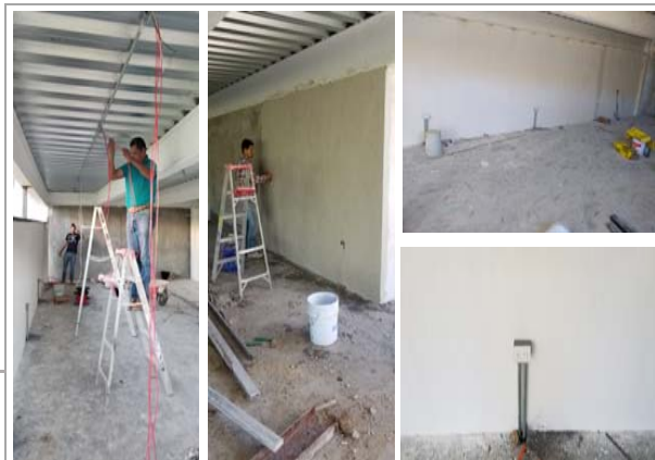
F3: Muros y salidas eléctricas
