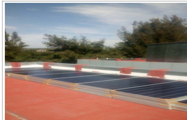
F4: Suministro en azotea
